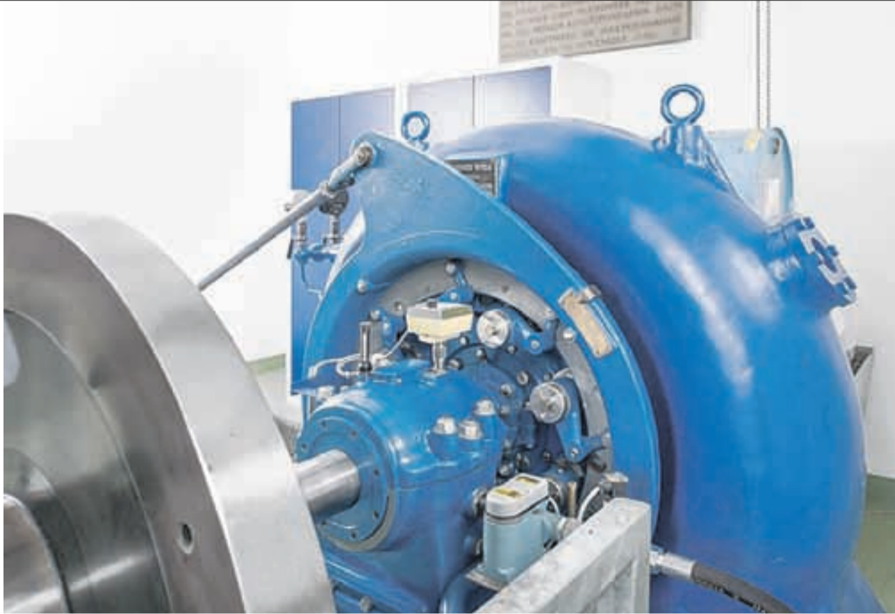
Blick ins Maschinenhaus des Kraftwerks Bäch im Schlyffitobel: Hier wird mithilfe des Wassers aus dem Krebsbach waschechter Höfner Strom produziert.
